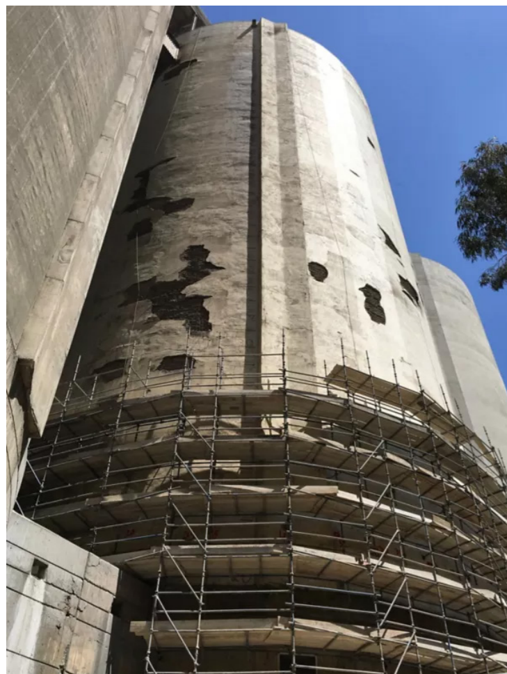
Antes dos trabalhos de reparação.
